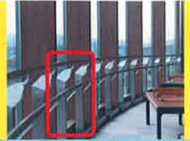
▲上図は高級のコンコースで使用されているフラットバー
